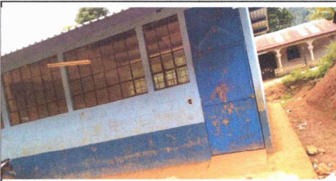
Foto 3: Puertas sucias por la falta de circulación
