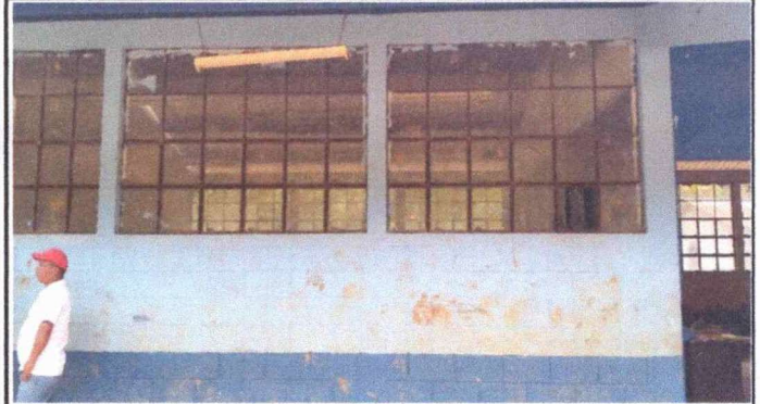
Foto 2: Aula en mal estado por la falta de circulación
